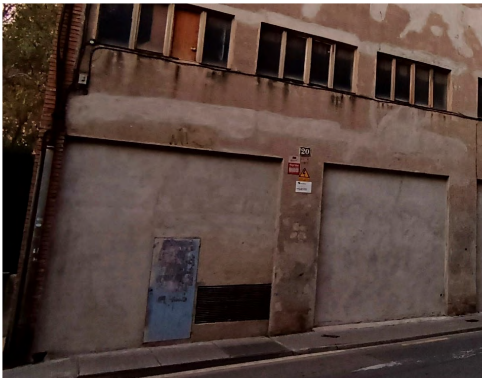
ZONA ÀMBIT ESTACIÓ TRANSFORMADORA (NO S'ENDERROCA) (ES FARÀ L'ENDERROC MANUAL EN TOT L'AMPLE I ALT DE LA NAU n° 16, FINS A UNS 6 M DE FONDÀRIA DES DE LA SEVA FAÇANA PRINCIPAL)
