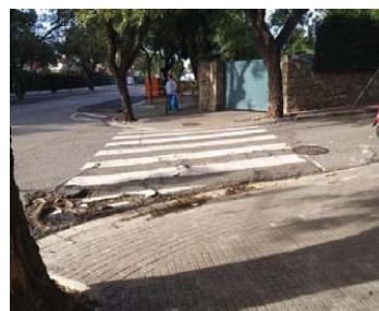
Fig. Carrer Lluís Borrassà. Mal estat paviment.
