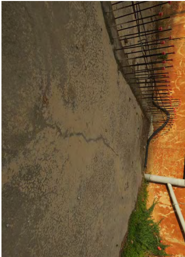
Foto 5 - Fisssures en soleres a segellar
