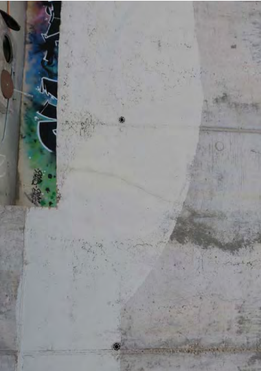
Foto 6 - Mur amb fisssuració, a segellar i protegir davant la carbonatació
