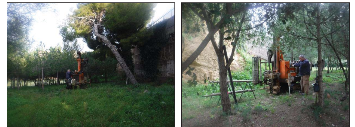
Máquina de sondeos en la zona del sondeo S-1. Máquina de sondeos en el sondeo S-2.
