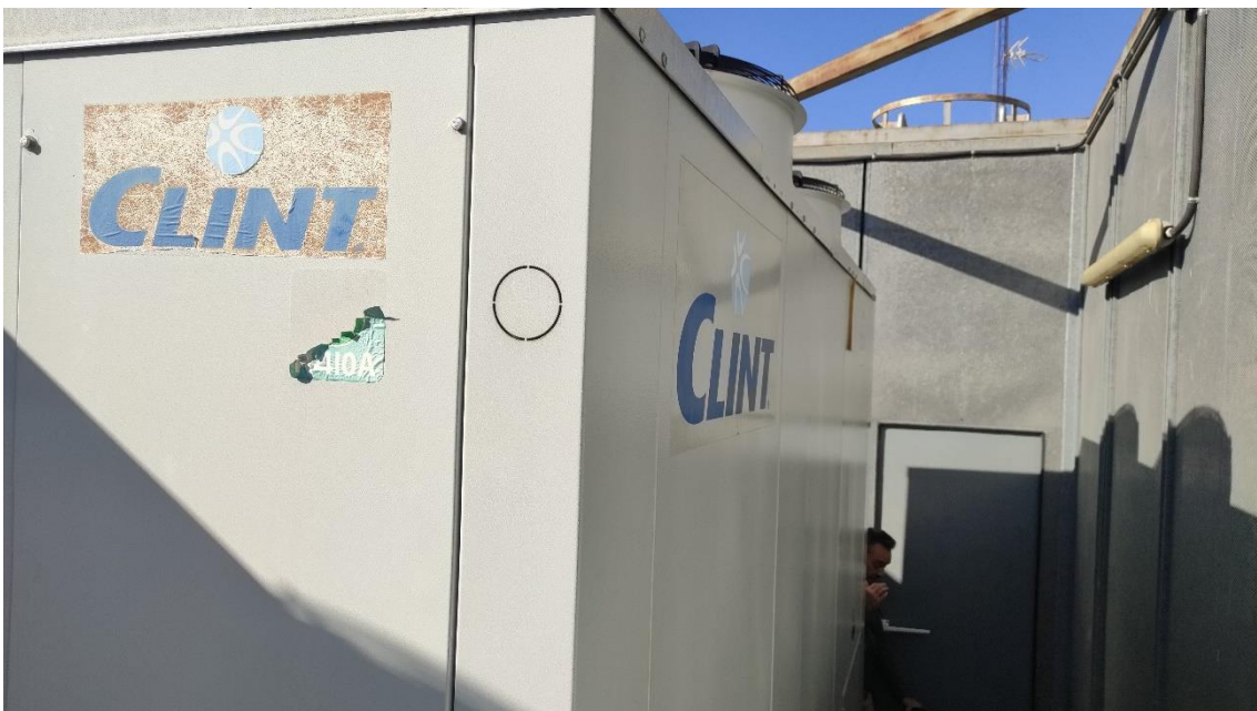
IMATGE MAQUINARIA DE CLIMATITZACIÓ A COBERTA
