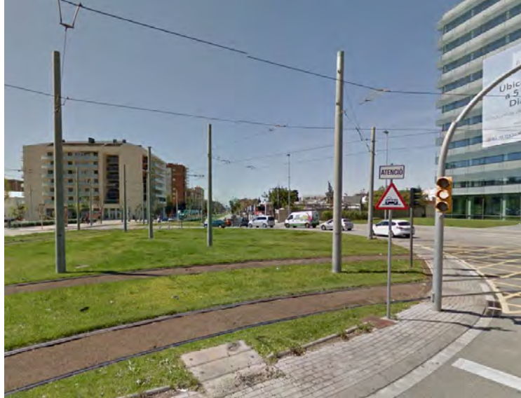
Figura 19: Catenària del Tramvia a la rotonda de l'Av. Cornellà – Av. St. Ildefons
